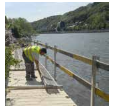
Garde-corps pour maintenance
